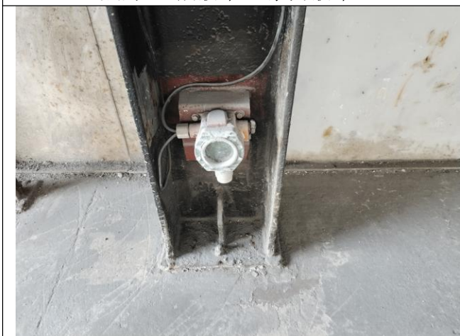
照片 9 生产车间内的有毒气体报警器
