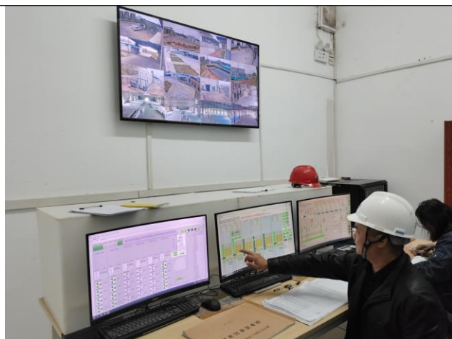
照片 14 DCS 控制室
