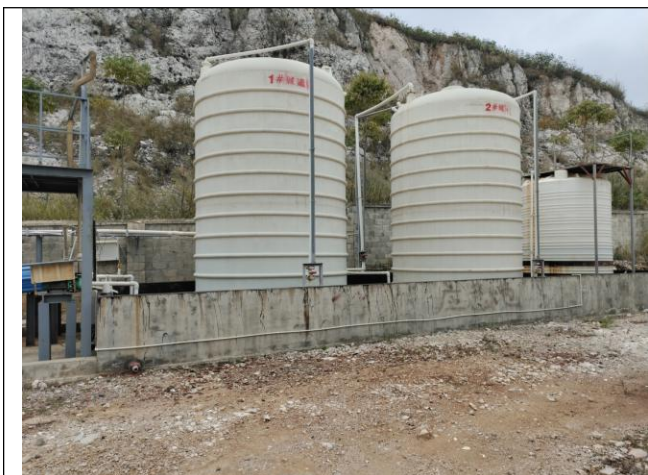
照片 7 碱液罐（漂白液罐）
